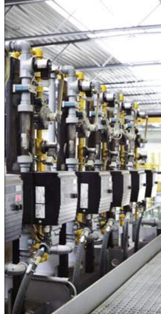
Mischbatterie und Steuerungselektronik einer Recon®-Beheizung
